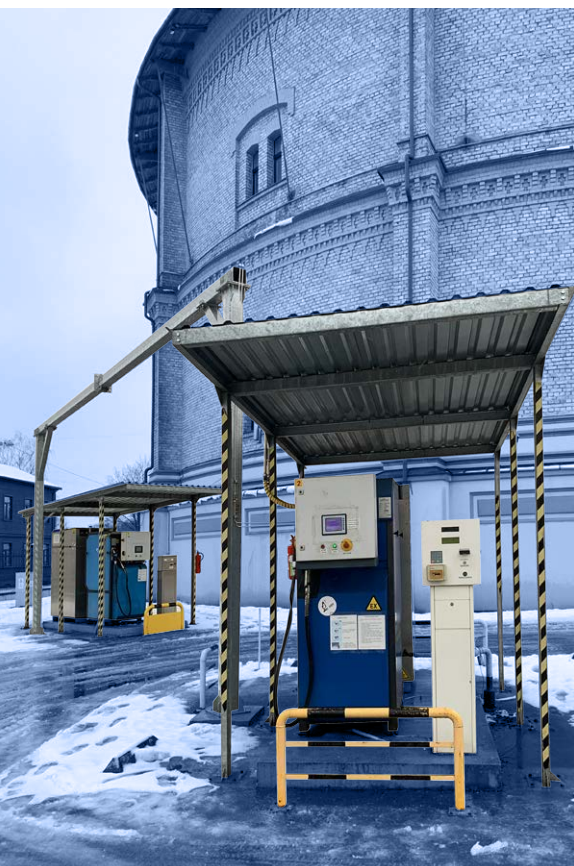
Vagonu ielā 20 izvietotās CNG uzpildes iekārtas
